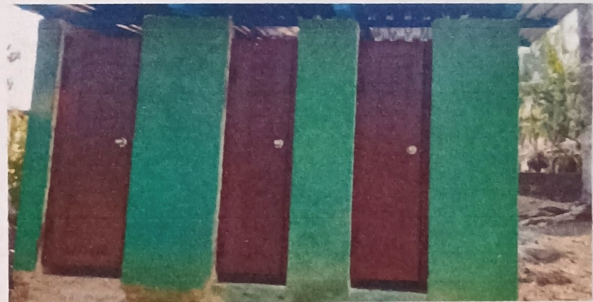
Foto 4: Se observa que se le cambiaron las tres puertas al baño.
